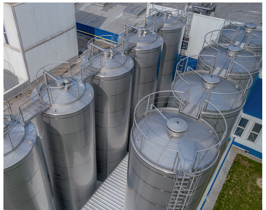
Een roestvast staal installatie is door zijn lage levenscycluskosten vaak de meest rendabele keuze
